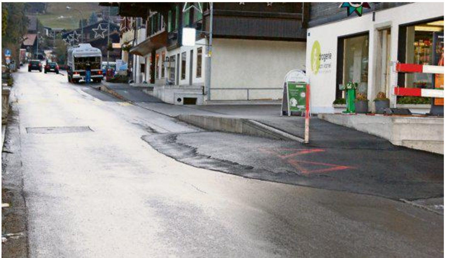
Provisorische Massnahmen vor der Drogerie: Dieser Übergang an der Bahnhofstrasse Reichenbach wirkt wie eine Massnahme zur Verkehrsberuhigung, die aber im Frühjahr wieder entfernt wird. Rösi Reichen
